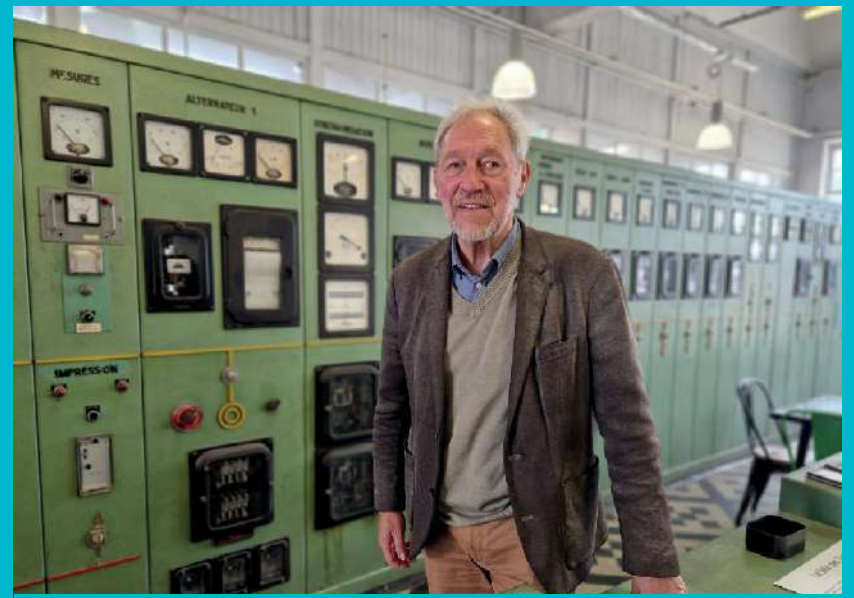
François Tacquard, au cœur de la Salle des Turbines, dernière étape des 250 ans d'histoire industrielle du Grand Circuit Ecomuséal Vivant du Parc de Wesserling.
